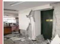
(※)東日本大震災後のA市役所の損傷状況
